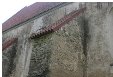
lagunenud krohv ja vuugid -väga lühike räästas, vihmaveesüsteemi puudumine
