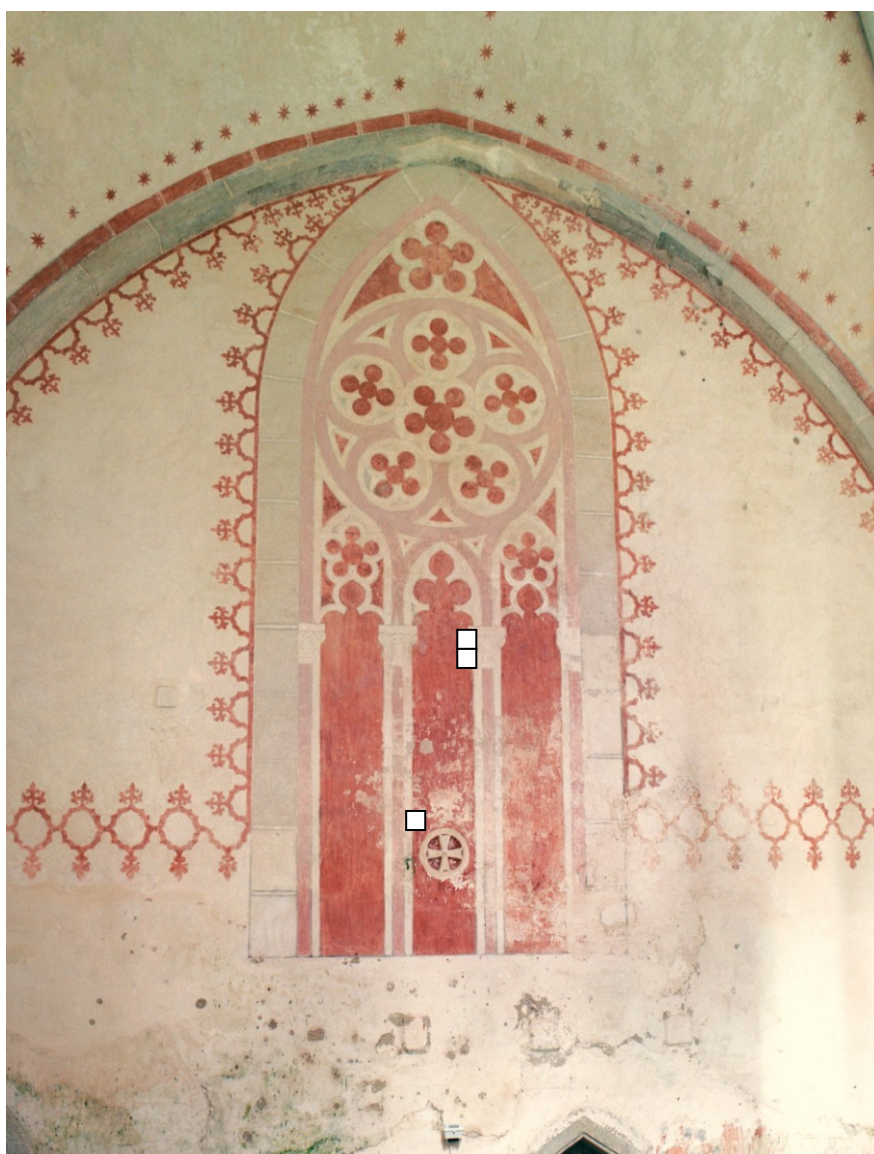
Foto 1. Karja kiriku kooriruumi põhjaseina maaling. Kastikestega on märgitud uuringute käigus teostatud sondaažide asukohad.
