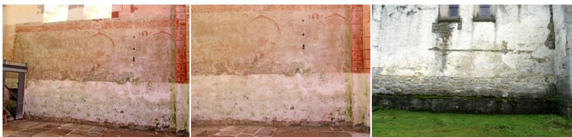
Seina sisekülj kahjustunud seinamaalingutega
